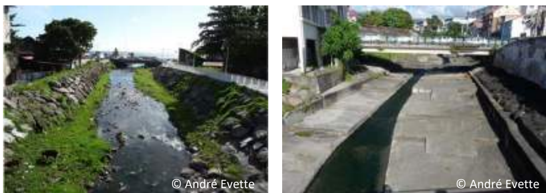
Figure 1 Exemples d'aménagements en génie civil de berges de cours d'eau en Guadeloupe.
